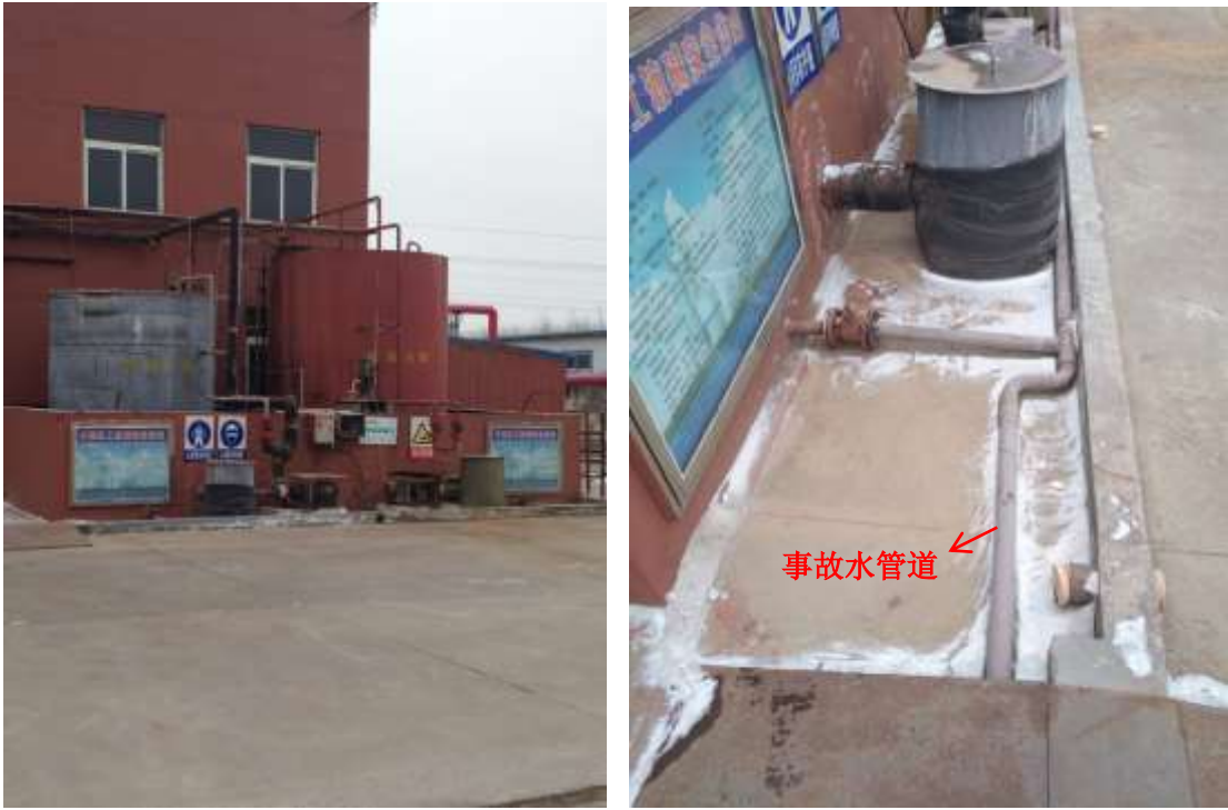
图 4-6 罐区围堰、事故水管道
