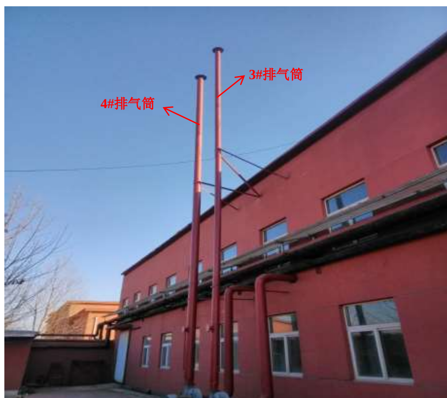
图 4-5 布袋除尘器排气筒
